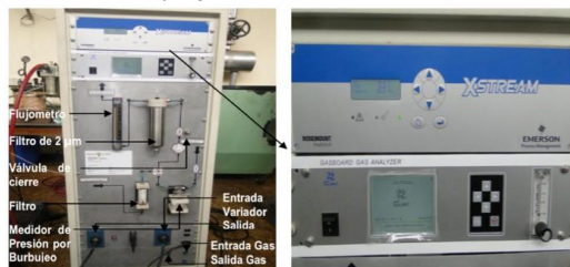
Fig. 4. Sistema de Analizadores de Gases. [6]
