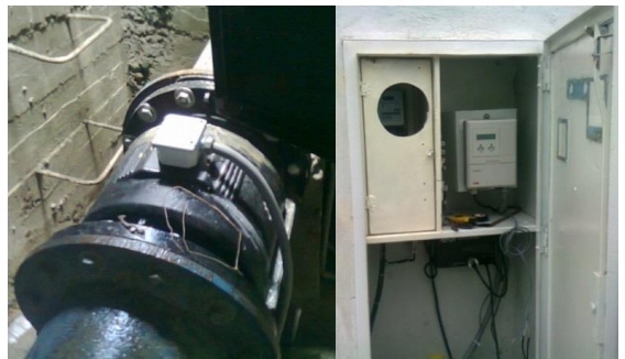
Figura 12. Caudalímetro ABB Magmaster (izq), Tablero de adquisición de variables, visualización e interfaz (der).
