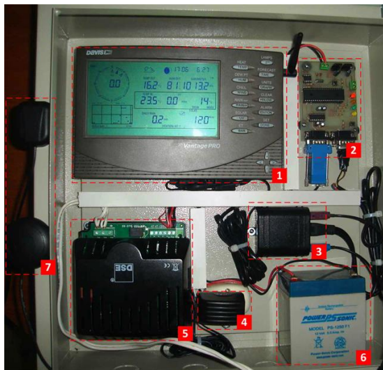
Figura 9. Interconexión de los elementos de la Estación Remota.
