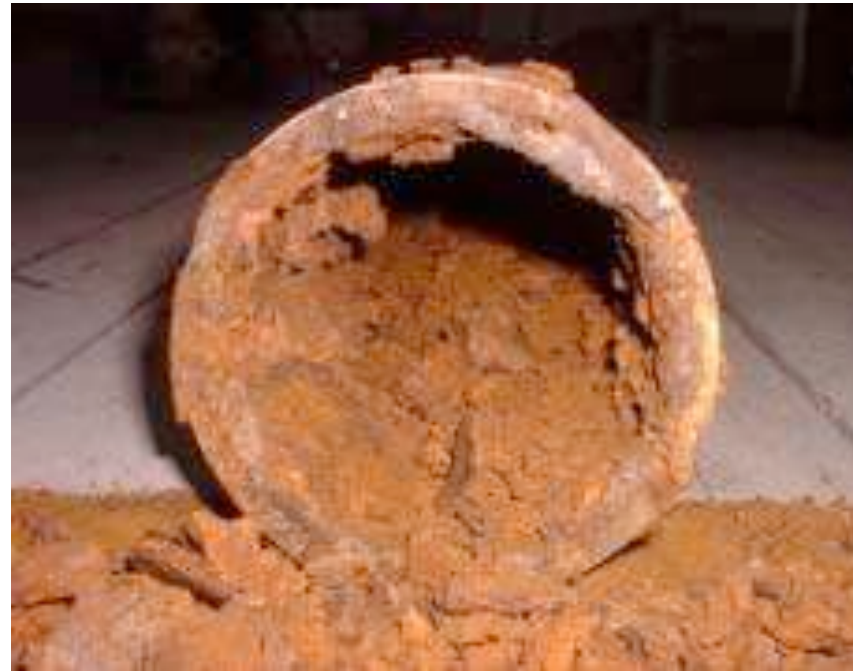
Tubería de fundición con sedimentación e incrustación
